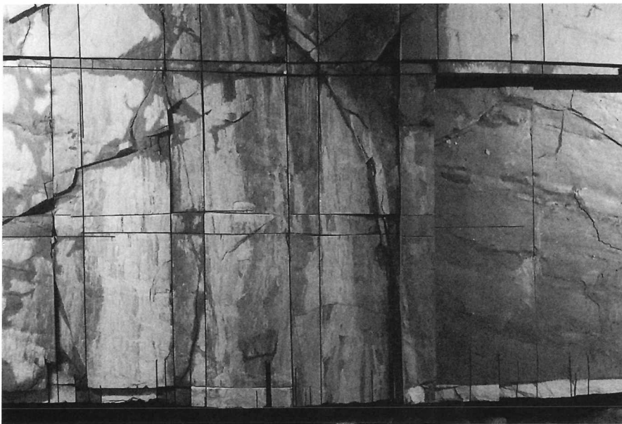
Abb 7: Ausschnitt der Ortsbrust mit einem typischen Kluftmuster (rechtwinkliges Sägeraster, Bildhöhe ca. 3,5 m).
