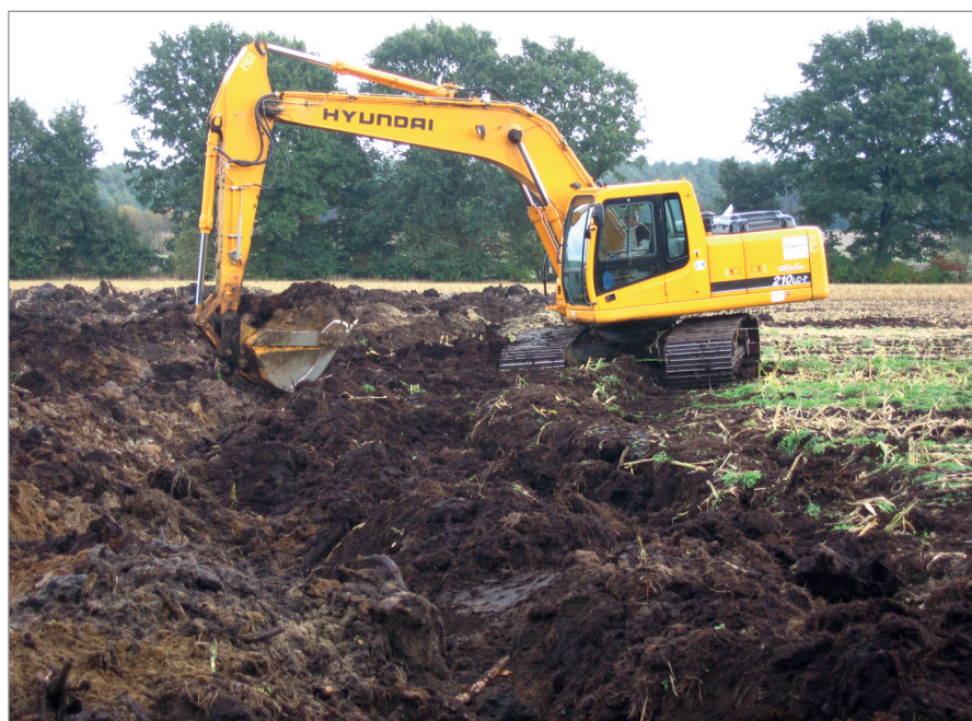
Abb. 8: Kuhlungsarbeiten im Uchter Moor. Wie beim Umgraben mit dem Spaten werden beim Kühlen der mineralische Untergrund mit den Torfen mit Hilfe eines Baggers vermischt. Rural engineering in the Uchter Moor. Like digging with a spade, the remaining peat is mixed with the underlying mineral soil by a dredger.
