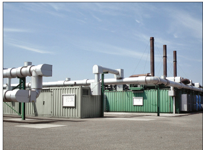
Abb. 4: Mobiles Blockheizkraftwerk zur Nutzung von Grubengas
