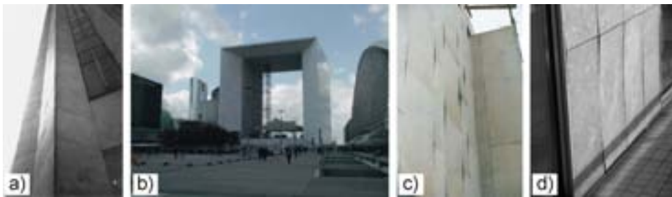
Abb. 2.8: Prominente Beispiele von Gebäuden mit verbogenen Fassadenplatten: a) Das Amoco Building in Chicago (aus Logan 2004), b) der Grande Arche de la Défense in Paris, c) die Finlandia Hall in Helsinki (um 1999) und d) das St. Marien-Hospital in Lünen (Balkon).
