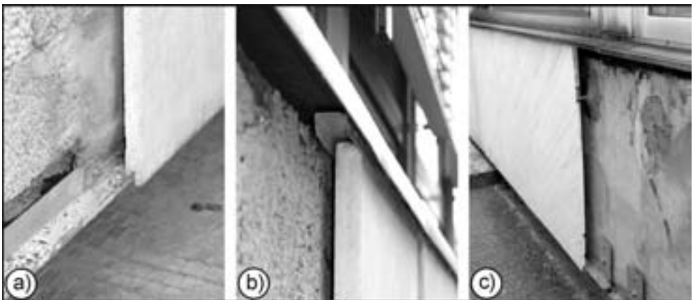
Abb. 4.3: Befestigungssystem der Fassadenplatten. a) Die Unterkante der Platten steckt mit der Nut an der Schiene, die am Mauerwerk befestigt ist. b) Die Oberkante der Platten steckt frei beweglich in der Leiste. c) Die Platten am Juridicum sind im oberen Drittel seitlich mit Ankerdornen befestigt.
