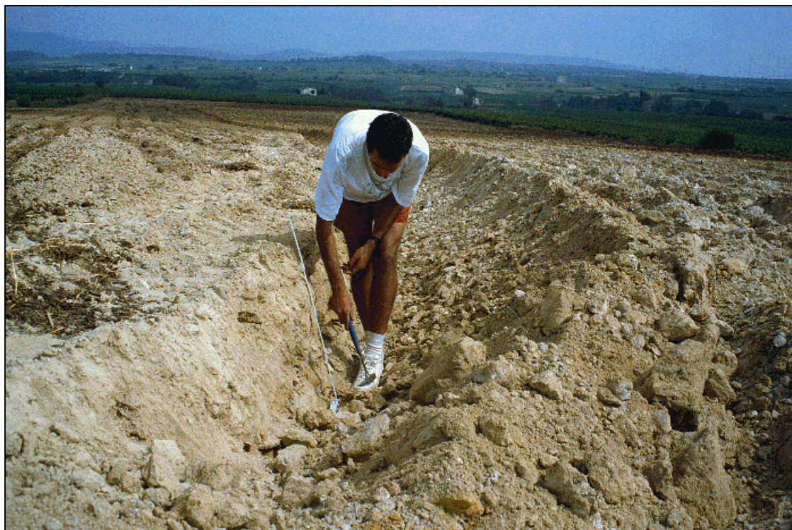
Figura 3.19. Operación de volteo de la parte superior del suelo previa a la plantación de viñas en una parcela.
