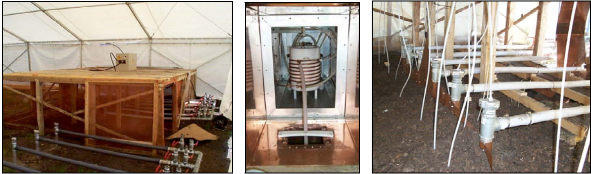
Abb. 23 Komponenten zur Radiowellen-Bodenerwärmung am Feldstandort Leipzig: Abschirmung des Versuchsfeldes und HF-Transformator ( links ), Detailansicht des HF-Transformators ( Mitte ) und als Absaugbrunnen dienende „heiße“ Elektroden ( rechts )
