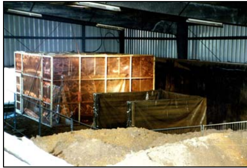
Abb. 20 Versuchsanlage zur HF-Bodenerwärmung mit elektromagnetischer Abschirmung der beheizbaren Bodenmiete
