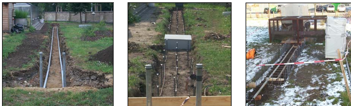
Abb. 17 Feldversuchsstandort F2 zur Untersuchung des Verhaltens von Stabelektroden: Elektrodenanordnung mit in der Erde verlegten parallelen Stabelektroden vor der Verfüllung ( links ), verfüllter Graben mit installierten optischen Temperatursensoren ( Mitte ) und Elektrodenanordnung mit auf der Erde verlegten Stabelektroden ( rechts )
