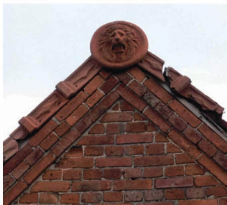
Schlussstein am Stallgiebel Port Arthur Capstone of a stable gable of Port Arthur
