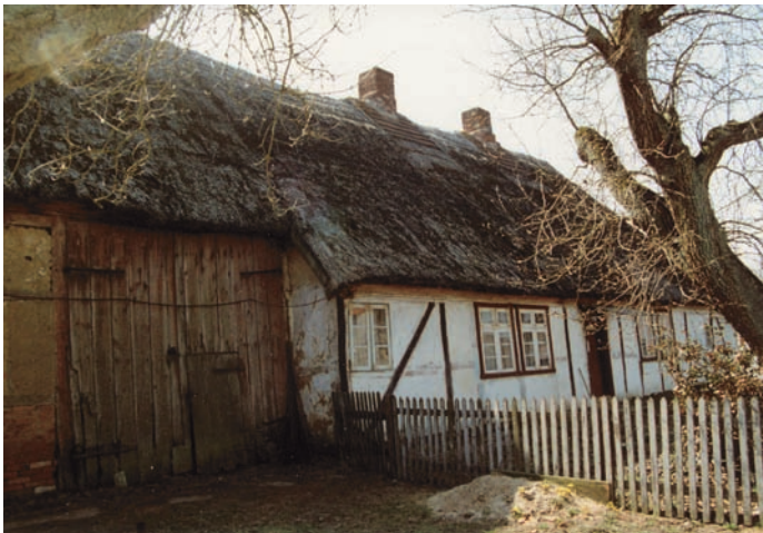
Querdielenbüdnerei in Below, Zustand im Jahr 2000 vor der Sanierung Smallholding (Büdnerei) with lateral entrance hall prior to its renovation in 2000
