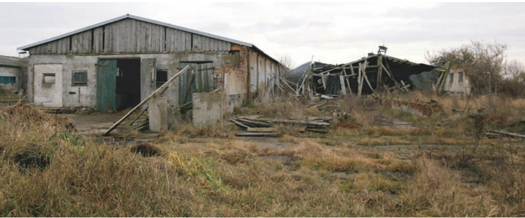
Viele Stallanlagen ehemaliger LPG werden nicht mehr genutzt und verfallen Many former livestock buildings are no longer in use and fall into disrepair
