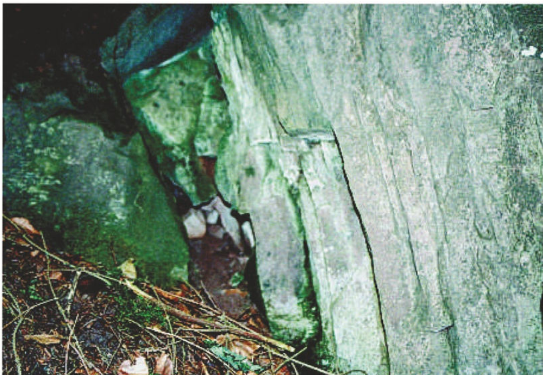
Abb. 13: Zentimeter-dicht geklüftete Sandsteine in einem Bereich horizontaler Scherbewegungen am östlichen Kyllufer (Lokalität [5] in Abb. 9).
