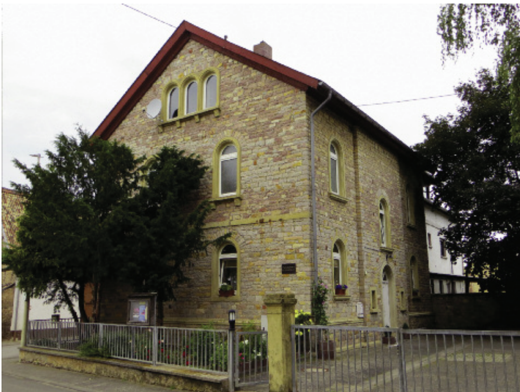
Abb. 24: Mauerwerk aus Rhyolith an einem Nebengebäude des Evangelischen Gemeindehauses in Pfaffen-Schwabenheim (Foto: HÄFNER 2013).
