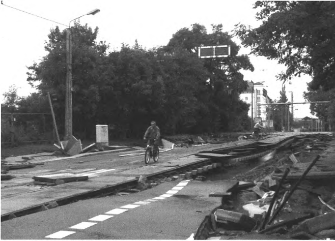
Zerstörung der Freiburger Straße durch die Weißeritz Fotos: C. Bethge
