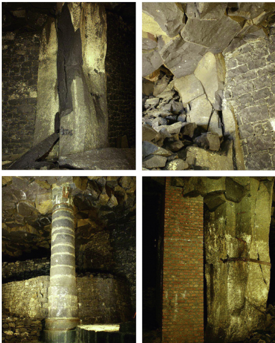
Abb. 5: Beispiele für Pfeiler auf dem Blatt 01 der ingenieurgeologischen Karte des LGB. Die oberen beiden Fotos zeigen die natürlichen Restpfeiler P010404 (links) und P011008 (rechts). Diese Pfeiler weisen erhebliche Brüche auf und sind hoch bzw. sehr hoch gefährdet. Im Bild unten links ist ein historischer, künstlicher Pfeiler aus gestapelten Mühlsteinen abgebildet (Pfeiler P011111) – der Pfeiler ist intakt und von ihm geht keine Gefährdung aus. Das Bild unten rechts zeigt den natürlichen Basaltpfeiler P010809 (mittlere Gefährdung) sowie den gemauerten Pfeiler P010803 (keine Gefährdung). Der natürliche Pfeiler weist historische Metallpinne und -gurte auf, die noch intakt sind (Fotos: MASSENKEIL, ROTHE).
