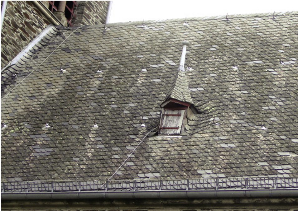
Abb. 4: Die Pfarrkirche St. Maria-Magdalena von 1903 (Zilshausen/Hunsrück) zeigt neben fachgerechten Reparaturstellen noch die Originaldeckung mit Dachschiefer von Lütz (karbonathaltiger Sphärosiderit-Schiefer, Oberems-Stufe, Unterdevon).
