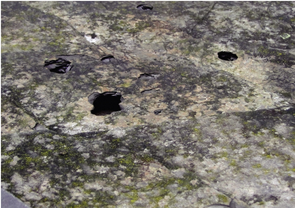
Abb. 6: Krustenbildung bei einem karbonathaltigen Dachschiefer. Die Löcher sind durch Hagelschlag entstanden. Die grau-gelblichen bis rötlichen Verwitterungsfarben sind typisch für diese Schiefer (Westfälischer Schiefer, Mitteldevon; 50 Jahre alte Deckung, wie Abb. 9b oben).
