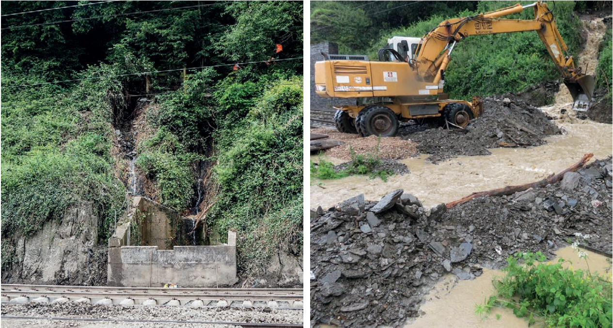
Abb. 2: (links): Tal (1) drei Tage nach dem Murgang. Das Murenmaterial ist bereits weitgehend beräumt. Hier ist ein Einlaufbauwerk zu einem Entwässerungskanal unter der Gleisanlage vorhanden (Foto: A. WEHINGER, 28.06.2016). Abb. 3: (rechts): Tal (2) kurz nach dem Murgang. Das Murenmaterial ist noch von starkem Abfluss betroffen. Der abgelagerte Schieferschutt des Murgangs liegt noch auf den Gleisen (Foto: H.-J. MATTHESIUS, 25.06.2016).
