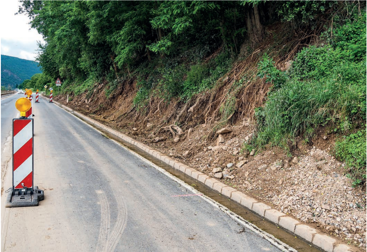
Abb. 13: Außerhalb der Tälchen floss der Starkregen vom 25.06.2016 flächenhaft in Richtung Rhein ab und verursachte am Fuß der Böschung Erosionsschäden. Die Aufnahme zeigt die B9 (Blick nach Süden) am 28.06.2016. Zu diesem Zeitpunkt waren die Lockergesteinsmassen von der Straße bereits beräumt (Foto: A. WEHINGER).
