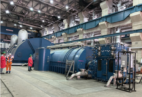
Der Generator eines BOA-Blocks liefert 1.100 MW Strom (Foto: B. Obermaier).
