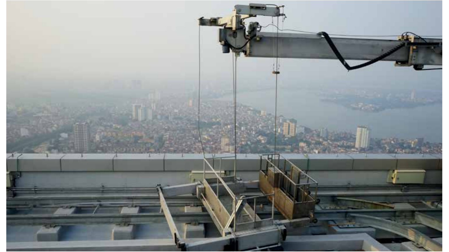
Hình 7.4. Thiết bị bảo dưỡng công trình đặt lên xe chạy trên đường ray trên nóc tòa tháp LOTTE (Nguồn: Michael Waibel, 2014)
