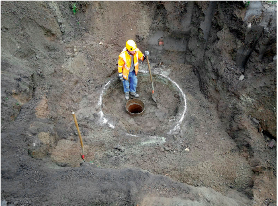
Abb. 8: Freilegung des Steinzeug-Kopfrohes eines der beiden rückverfüllten Altbrunnen. Erkennbar ist auch die Kontur des Schachtfundamentes auf der Baugrubensohle (Foto: H. Jobmann).
