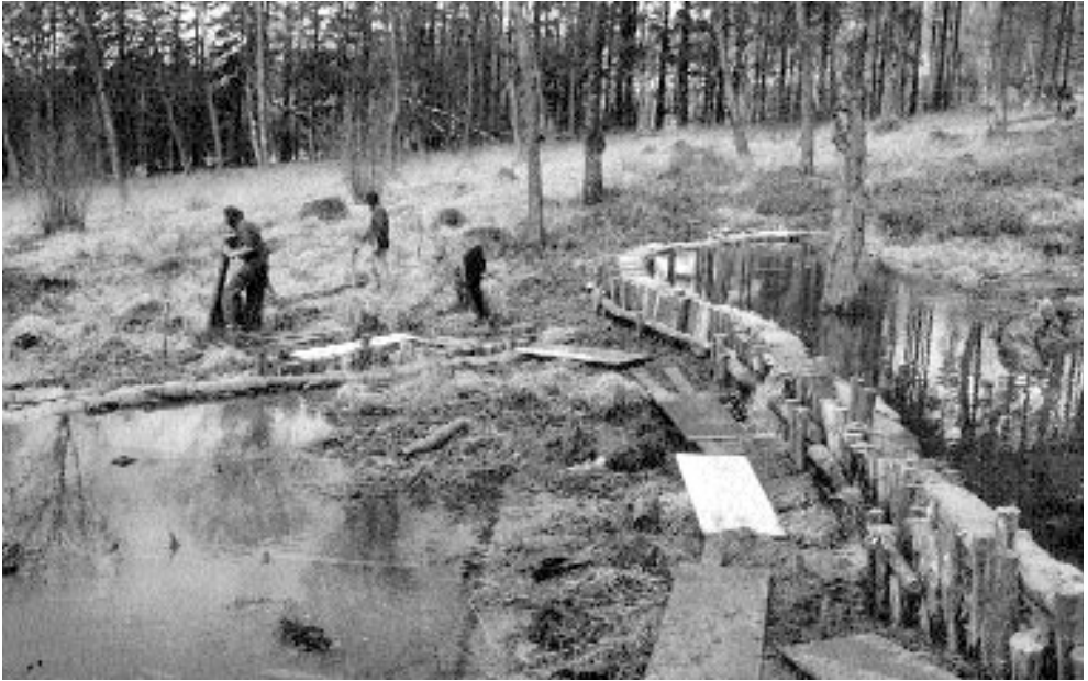
Abb. 9: Errichtung von Stauanlagen am stark entwässernden Hauptgraben im Oberluderbruch Construction of a dam at the main drainage ditch in Oberluderbruch
