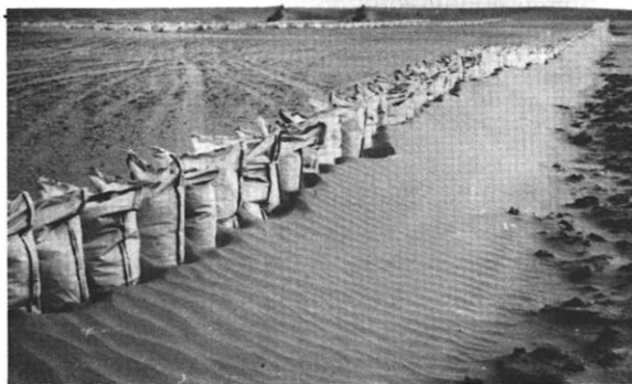
Abb. 10: Aus Sandsäcken errichteter Schutzzaun gegen Sanddrift an der Eisenbahnstrecke Golmud-Xining im nördlichen Qaidam-Becken. (Aufn.: Jäkel, 9.9.1986)
