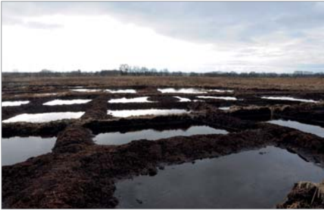
Abb. 14: Fertigstellung von Abtorfungsfläche 1 (FA-1) im Februar 2013 Completion of peat stripping area 1 (FA-1) in February 2013
