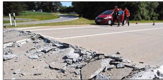
Abb. ÖN3.8: Dehnungsrücken (expansion ridges) in einem Straßenbelag, hervorgerufen durch thermisch bedingte Volumenzunahme; Quelle: Spiegel online, 10.08.2013.
