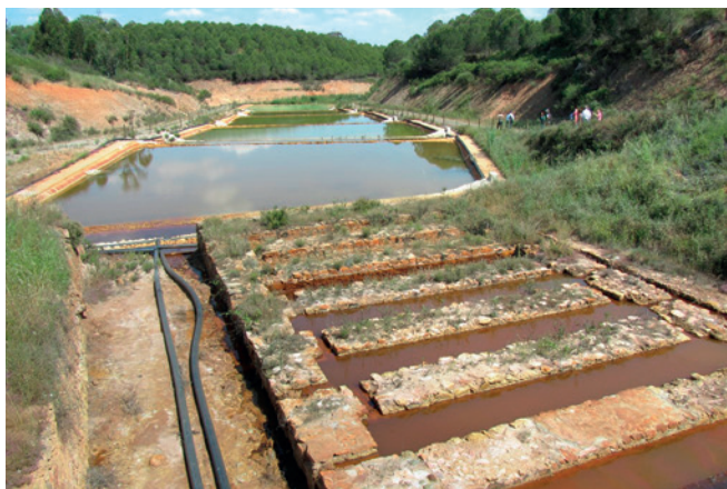
Abb. 2. Teichkaskade beim ehemaligen Pyrit-Bergwerk Lousal, mehrstufige chemisch-biologische Reinigung von Grubenwässern
