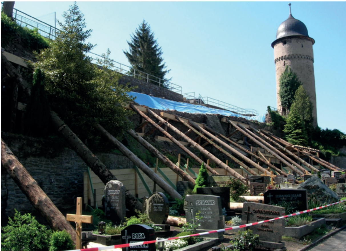
Abb. 2: Provisorische Abstützung einer durch Rutschmassen einsturzgefährdeten Mauer
