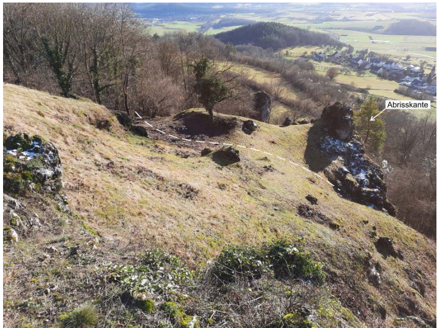
Abb. 30: Beginnende Ablösung einer Festgesteinsscholle hinter der Hauptabbrisskante der Massenbewegung SW_2. (Blickrichtung: S; Position: R: 655582 H: 5508942).
