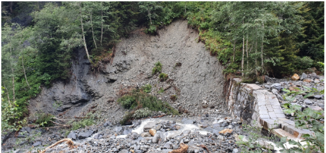
Abb. 39: Uferanbruch durch Erosion des übersteilten Hangfußes der Talzuschubsmasse. Blickrichtung: W, Koordinaten (Standort Bildaufnahme): 368776,48 237287,63.
