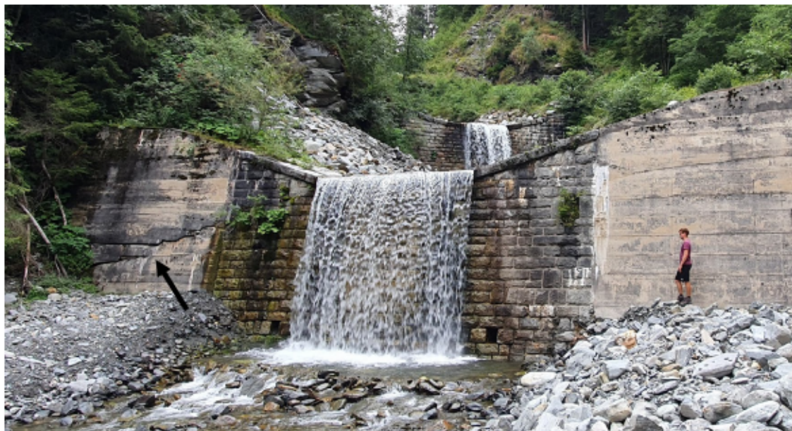
Abb. 34: Durch Gebirgsdrücke der Talzuschübe entstandene Risse (Pfeil) bei Sperre 42. Blickrichtung: N, Koordinaten (Standort Bildaufnahme): 368829,38 237173,9.
