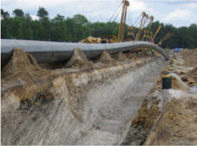
Abb. 2: Verlegung des Rohres in den Leitungsgaben bei Fürstenwalde. Man erkennt rechts die Grundwasserbrunnen. Aufgeschlossen sind im Vordergrund humose gut geschichtete Flusssande der Spree. Im Hintergrund werden sie von grauen Urstromtal-sanden/-kiesen unterlagert. Foto: O. Juschus
